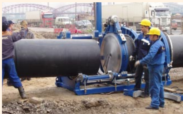
Санкт-Петербург, 2005 г. Сварка полиэтиленовых труб диаметром 900 мм проводится на надежном и современном оборудовании. Подобным оборудованием сегодня располагает большинство ведущих отраслевых строительных организаций.
